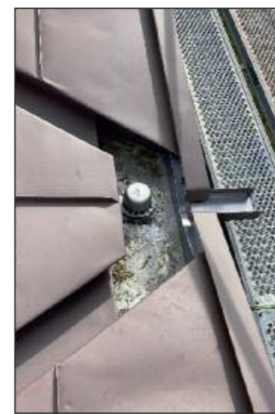
Die Dachentwässerung erfolgt über die Kehlen, ebenfalls hergestellt aus RHEINZINK-PRISMO rot, hin zu Entwässerungspunkten an den Dachrändern mit einer Druckentwässerung. Zusätzlich wurde jeweils der erforderliche Notüberlauf angeordnet, aufwendig an die Geometrie angepasst aus geschweißten Edelstahlblechen.
