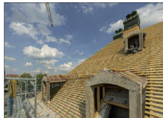
Das Dach des zum Teil denkmalgeschützten Gebäudes wurde im Zuge der Umgestaltung für das Archiv der Avantgarden authentisch wiederhergestellt. Für die Holzkonstruktion der Dachfläche wurden über 70 Kubikmeter Brettschichtholz und bis zu 11 Meter lange Sparren verarbeitet.
