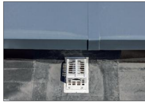
Auf dem nicht einsehbaren Flachdach geht es um (Abfluss-)Leistung. Durch die Wahl der Loro-Duoflux-Attika-Direktabläufe genügen zwei Ablaufpunkte, um die gesamte Fläche sicher zu entwässern.
